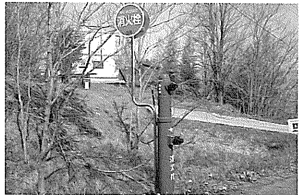
④ ホース取り付け部 の位置が高い消火栓
